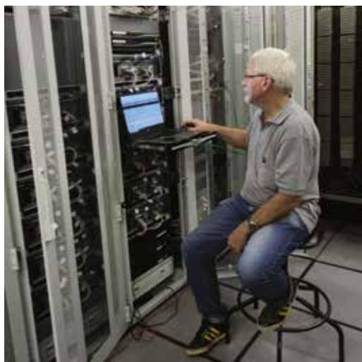
Representante da empresa ATC Systems fazendo a integração da solução gravadora da ATN-Br em um grupo de bastidores na sala técnica do CINDACTA III
