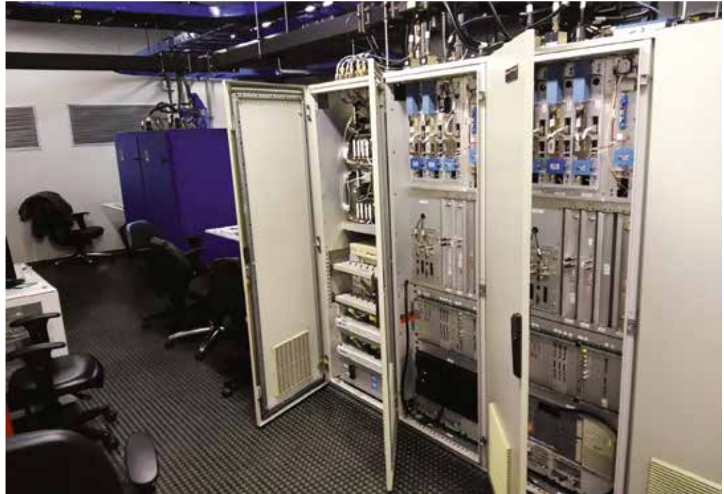
Gabinete dos equipamentos modernizados do sistema de radar da empresa Raytheon
