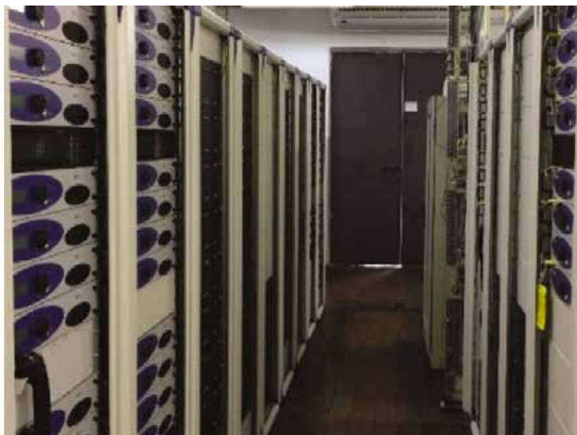
Bastidores de uma estação integrada de VHF da empresa Park Air
