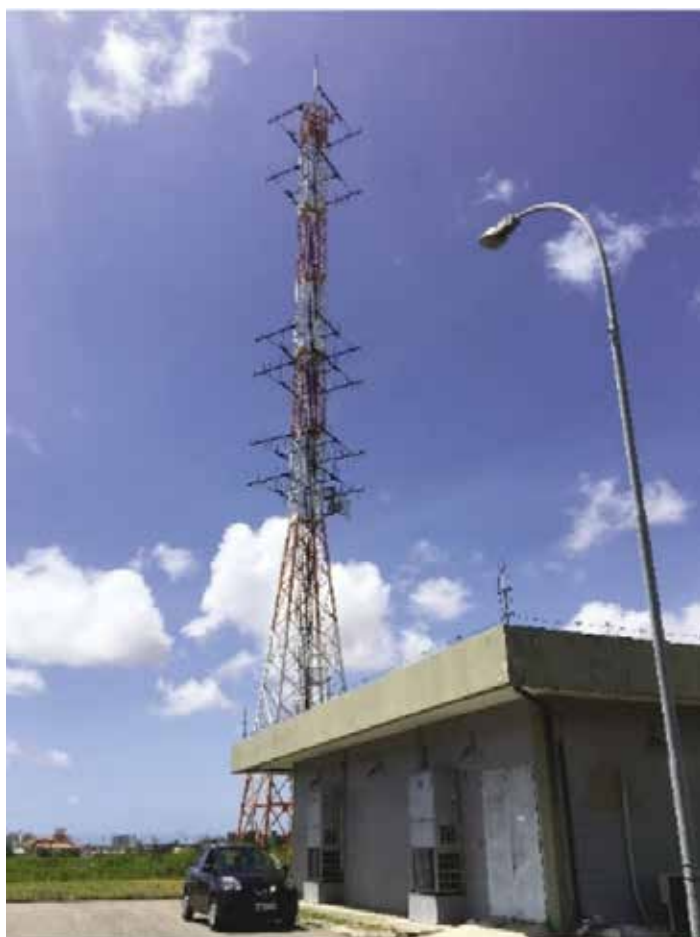
Torre com antenas de uma estação integrada de VHF
